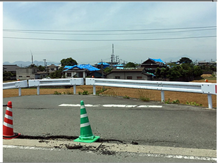
高速道路の亀裂
