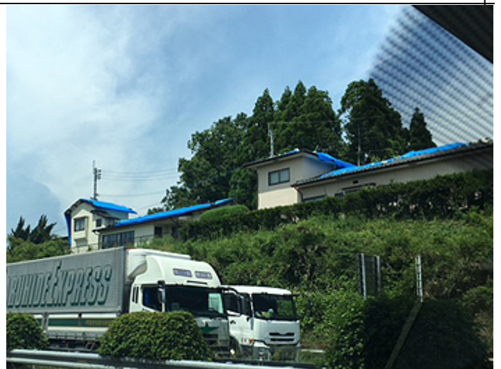
ブルーシートに覆われた屋根の落ちた家
